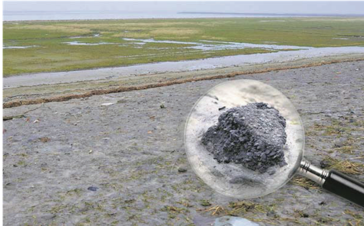
Im neuen Deichabschnitt zwischen Misselwarden und Padingbüttel hatte Orkantief „Xaver“ Anfang Dezember unter anderem Asphaltbrocken sowie Beton- und Eisenteile aus der Kleischicht herausgelöst. Foto Ullrich/Grafik NZ
